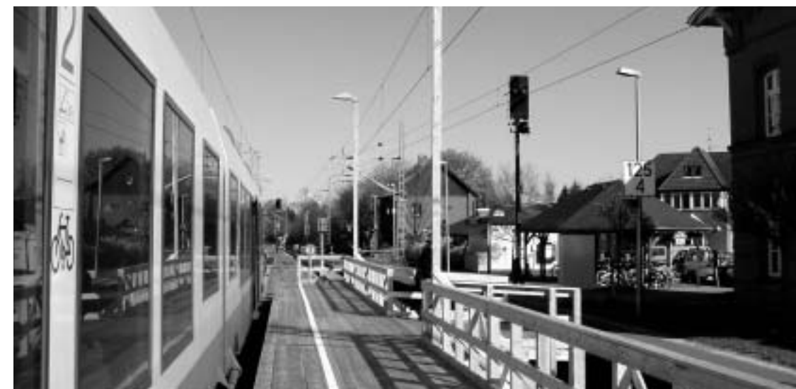
Im Zuge des eingleisigen Betriebes zwischen Owschlag und der Überleitstelle Lottorf musste in Owschlag ein Behelfsbahnsteig errichtet werden.
